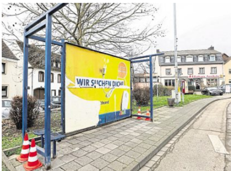
Die Bushaltestellen am Irlicher Weiherplatz sind schon teilweise zurückgebaut. Im Rahmen der Maßnahme werden sie versetzt. Foto: Jörg Niebergall
