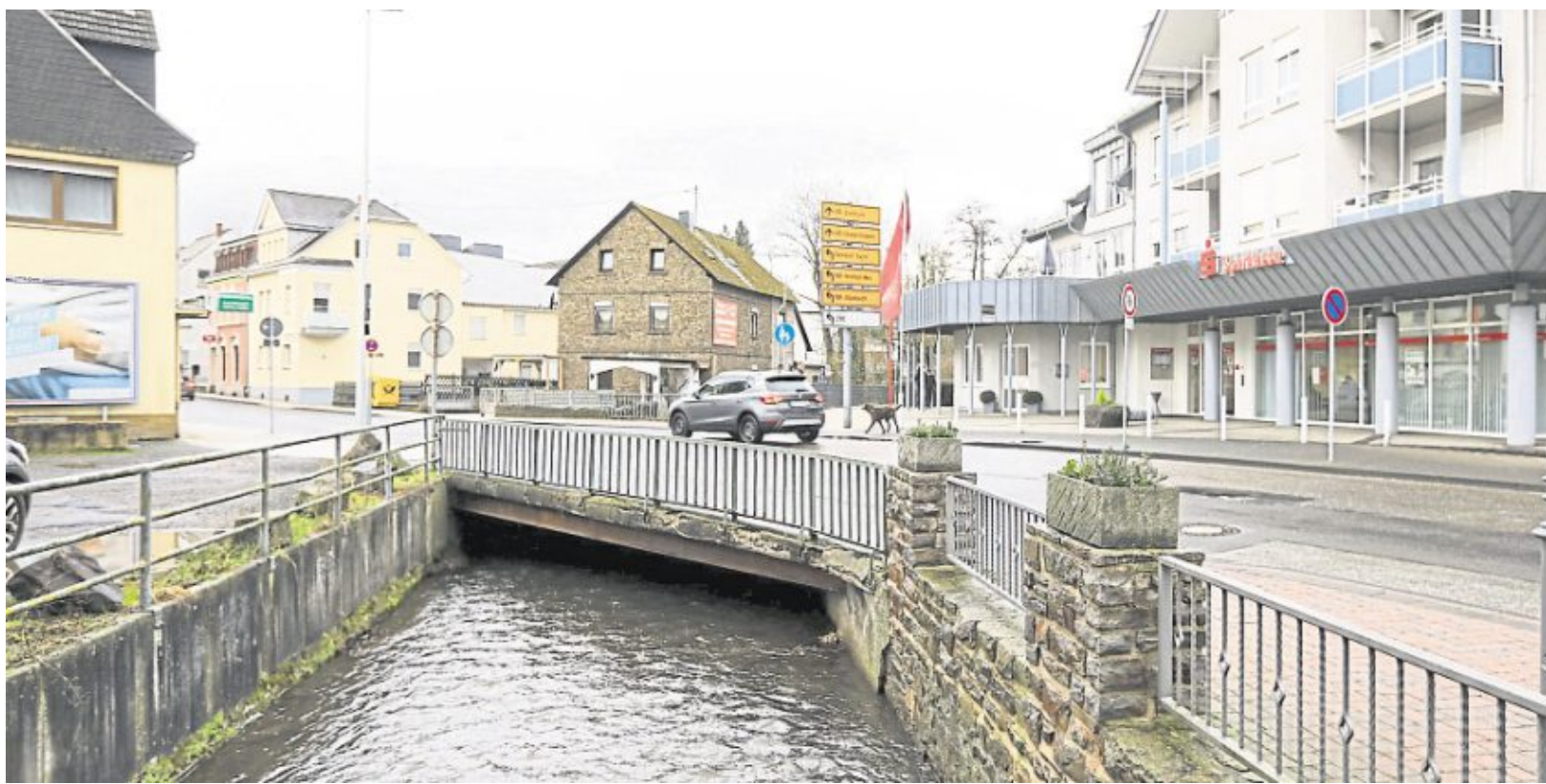
Die Tage der alten Aubachbrücke sind gezählt. Sie wird abgerissen und neu gebaut. Der Verkehr muss mehrere Monate umgeleitet werden. Foto: Niebergall
